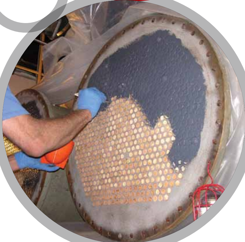
Intercambiadores de calor
